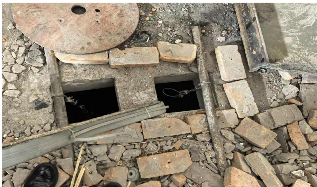
图 4：涉事电梯原穿引轿厢侧主钢丝绳的两个矩形孔洞
