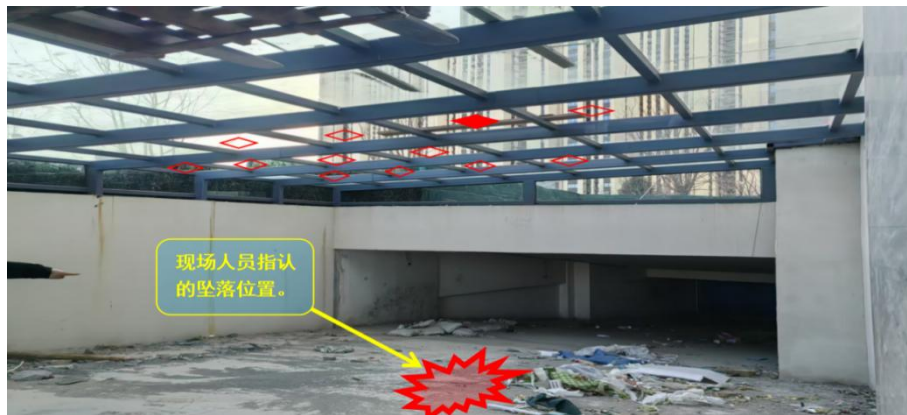
图 5：从雨棚下西北角处观察雨棚及车库坡道地面情况
