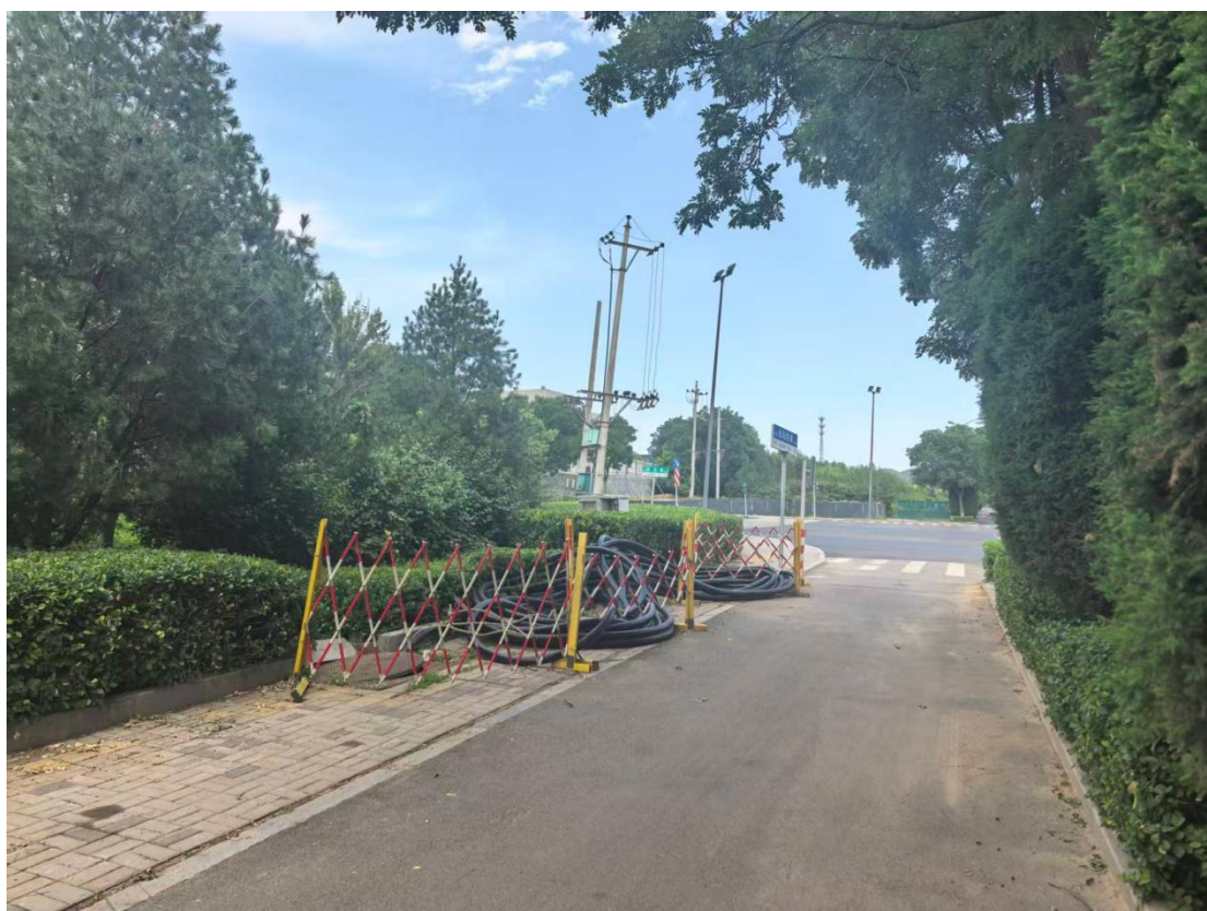
图 21 事发当日电缆敷设起始处（新沟路与长风东街交叉口西南角）
