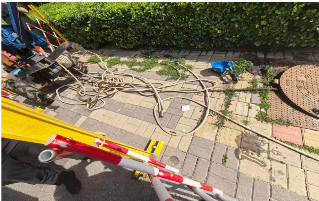
图 6 井盖与手扶拖拉机绞磨之间地面情况
