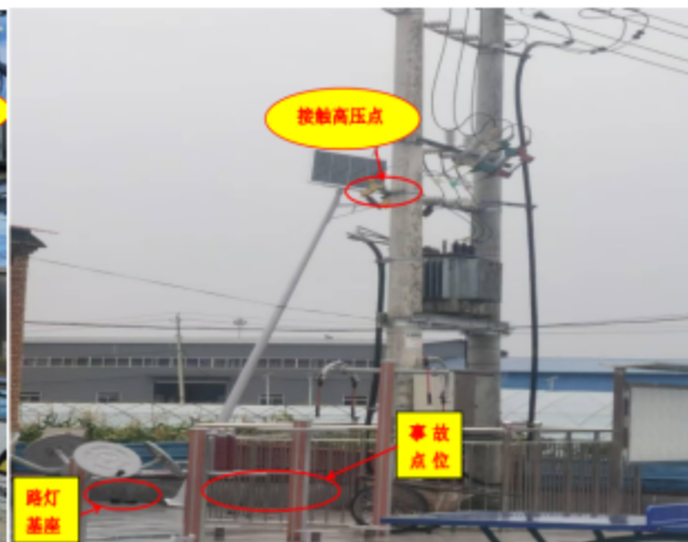
（太阳能路灯倾倒触电现场图）
