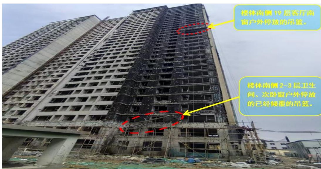
图 2：7 号楼南侧立面由下向上观察过火区域
