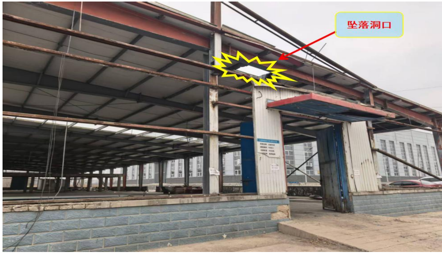
图 2：从门外西侧看坠落洞口所在位置
