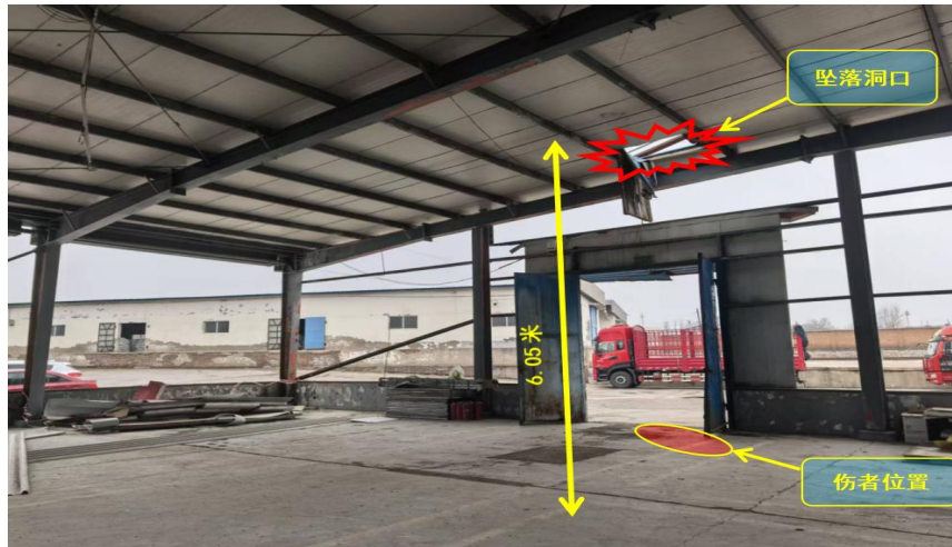
图 3：在车间内侧看门口处坠落洞口和伤者触地位置
